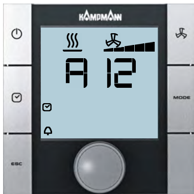
Ansicht Alarm „Motorstörung“
